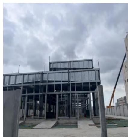
● 义盛110千伏输变电工程
