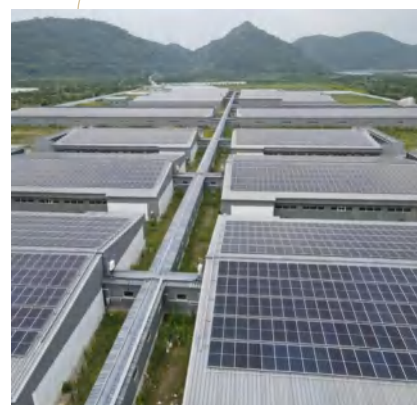
● 味央（三门）现代农业示范园4.45兆瓦高压（全电量上网）分布式光伏发电项目
